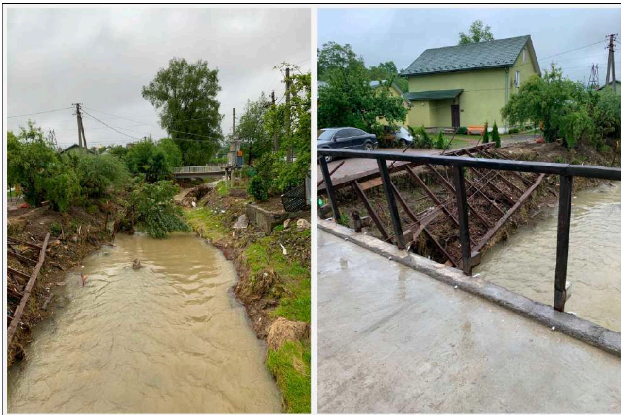
Рисунок 2.14 – Руйнування мосту через річку Східничанку під час паводку, с. Східниця, Львівська область (2023 рік) (джерело: фото автора)
